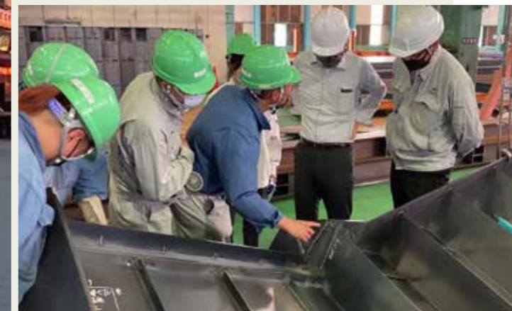
階段は3次元構造のため、製作には高い空間認識力が必要。ステアックスでは、正確性と速いスピードを保ち、高品質なものを提供
